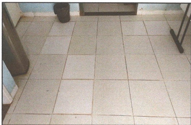
FIGURA 03 - Revestimento cerâmico danificado
