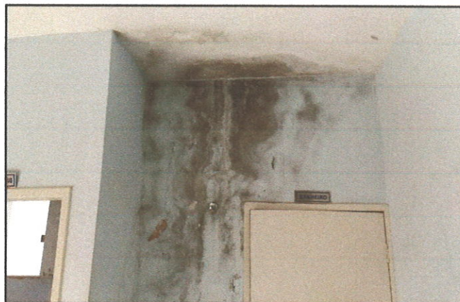
FIGURA 04 - Manchas na parede
