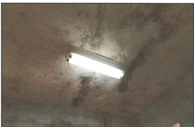
FIGURA 05 - Manchas no teto
